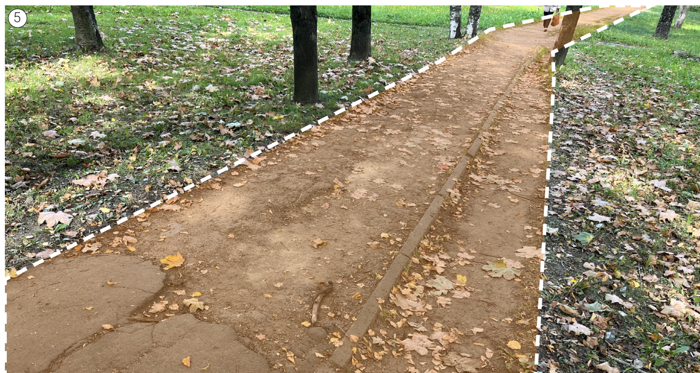
Неудовлетворительное состояние покрытий. Протопы вдоль основного пешеходного маршрута
